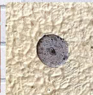
塗膜剥離状態
